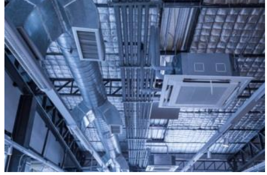
Isıtma, Havalandırma ve Klima (HVAC)
