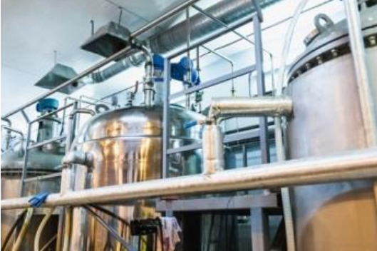
Endüstriyel Proses Soğutması
